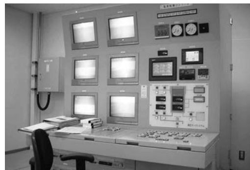
図6 監視制御コンソールの外観
