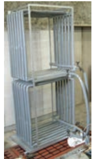
図5 70m配管部 (保温カバー有) および40m配管 (下半分)
