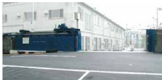
図2 機側操作方式(横引き陸閘)
