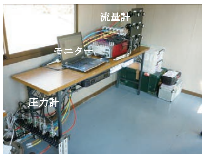
写真1 空気注入管理システム
