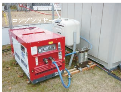
写真2 空気供給源（コンプレッサー）
