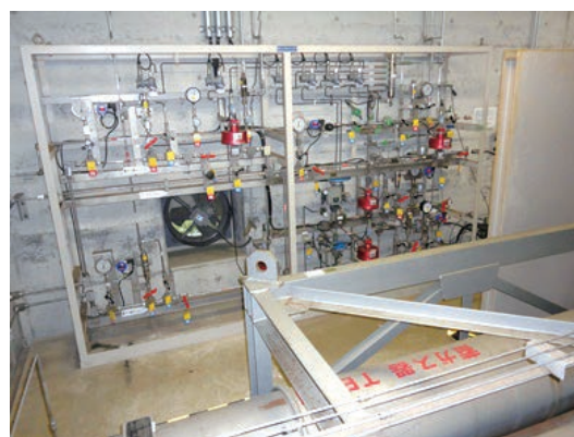
(b)通流試験配管・蓄ガス器
