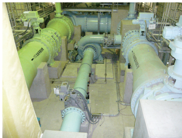
図12 妙典発電所水車発電機設置状況
