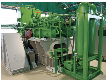
図7 久慈波力発電所油圧動力変換部外観
