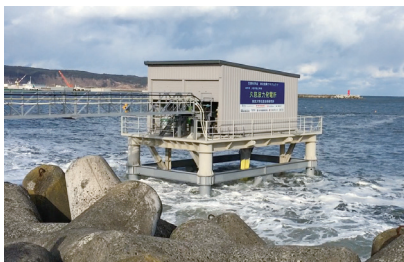
図6 久慈波力発電所運用状況
